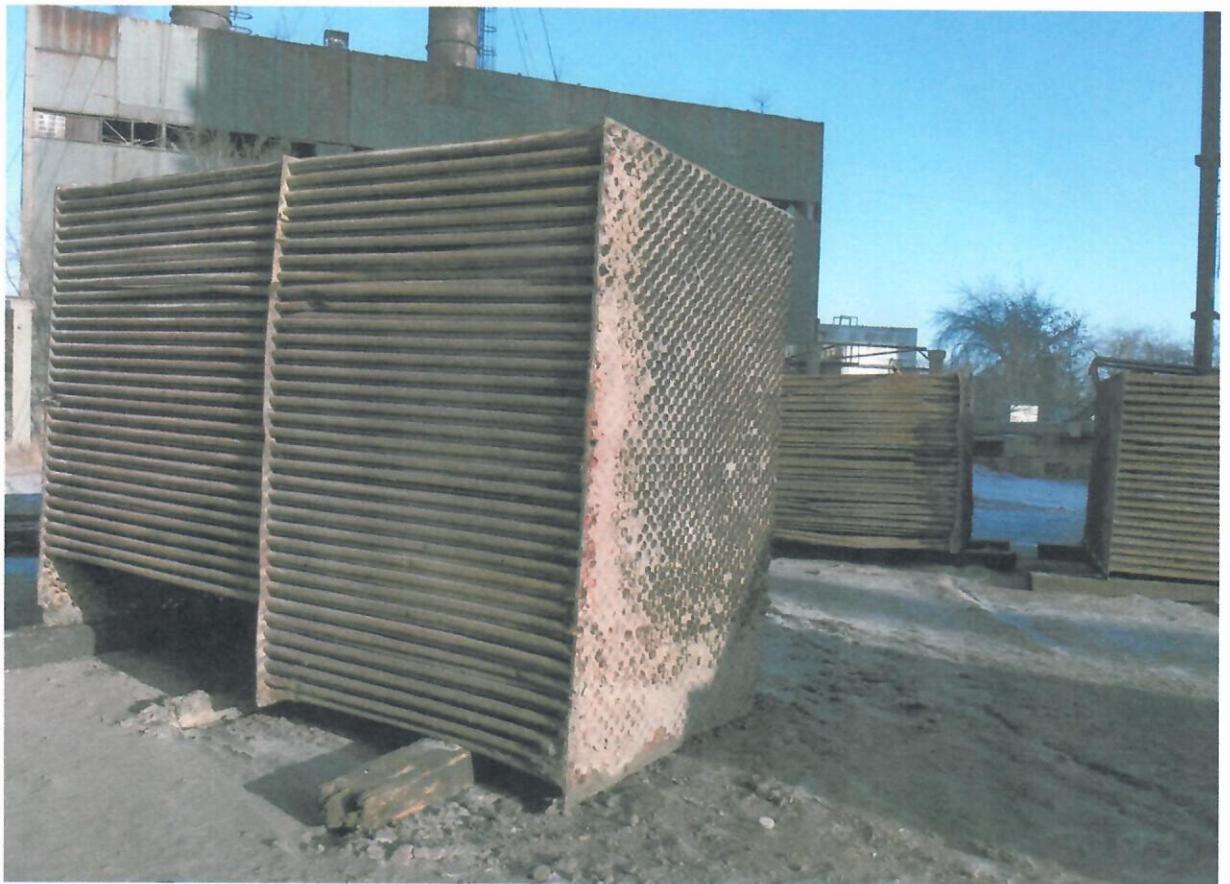
Фото №2 Демонтированные дефектные кубы.
