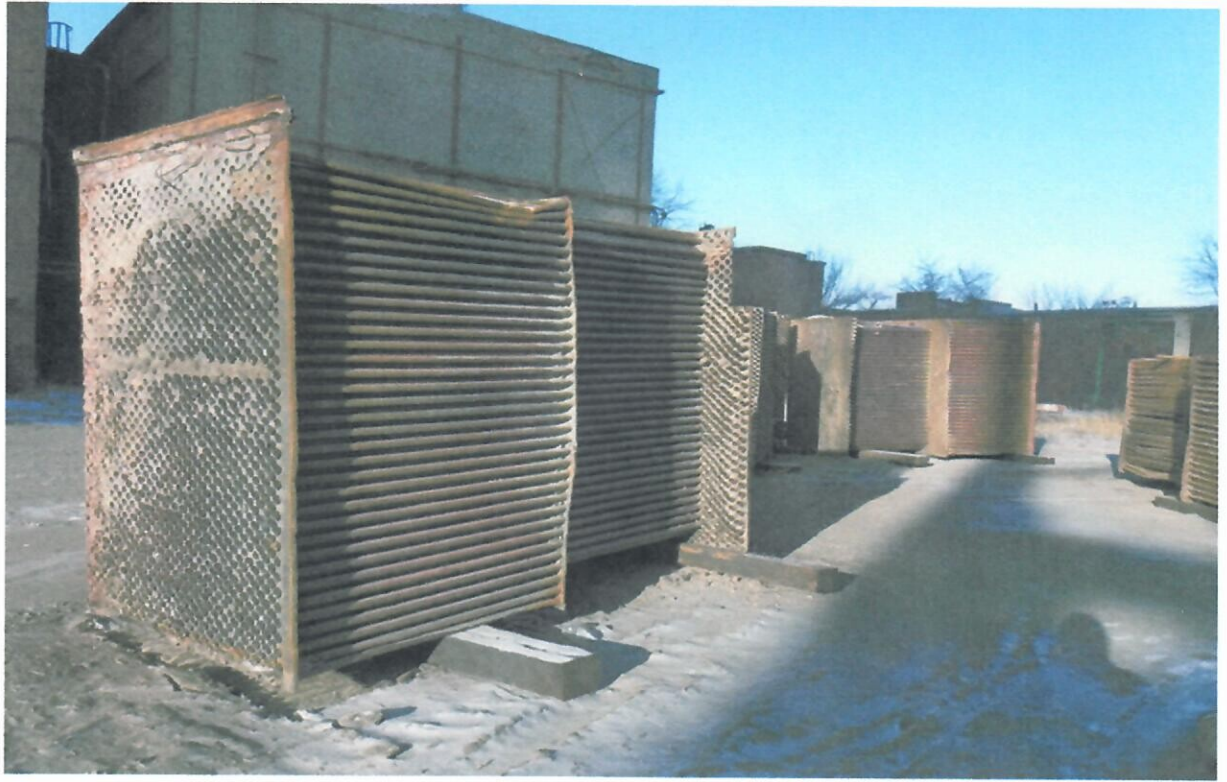
Фото №1 Демонтированные дефектные кубы.
